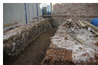
Rys.2 Wykopy fundamentowe. Grunt oraz istniejŃce fundamenty zabezpieczano przed przemarzaniem za pomocŃ weŃny mineralnej oraz plandek.
